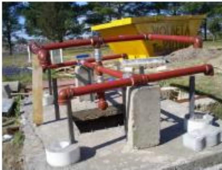
Figura 11. Fotografía del digestor de grasa de la planta de tratamiento en la empresa láctea Coleme. Obtenida de “biotecnología de procesos para el ambiente”. Departamento de Ingeniería de Reactores, Facultad de Ingeniería.
